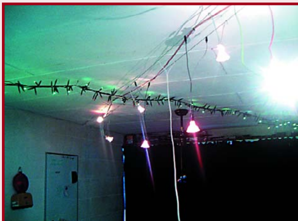
9. Bei so vielen Lampen kommt ein ganz schöner Einschaltstrom zusammen.
