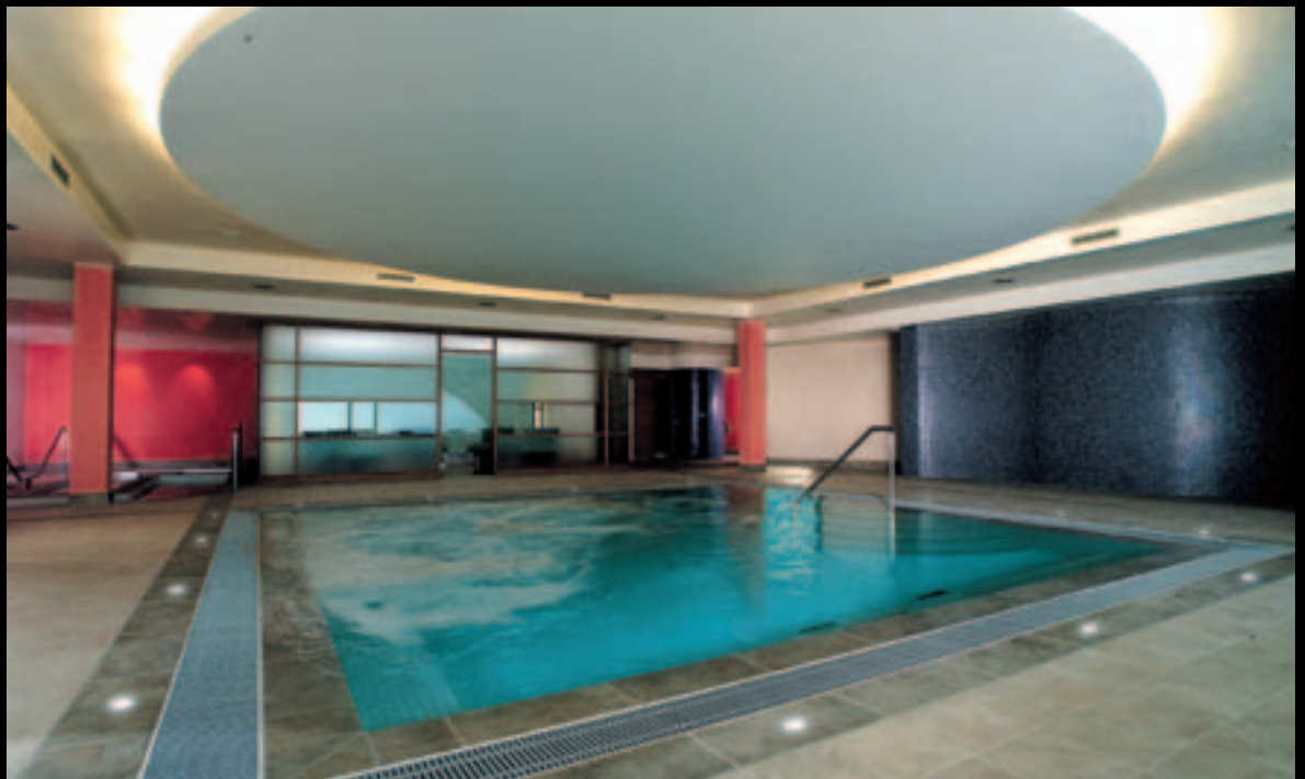
Privatvilla, umlaufende Beleuchtung des Hallenbades, Einbaulampen IVELA
