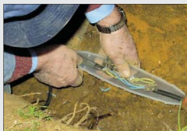
A kábelt a tápforráshoz víz alá süllyeszthető vagy zárt "3M salmon" csatlakozó dobozon (pl "Plexo") keresztül kell vezetni.
