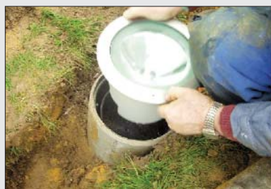
Ideális módon a fényforrást gyárilag kell beépíteni, megakadályozandó, hogy lezárás előtt nedvesség hatolhasson be a lámpatestbe.
