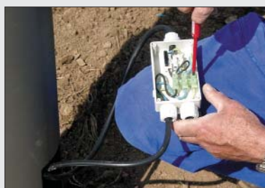
A hálózati kábel bekötése az oszlopban található csatlakozó dobozba
